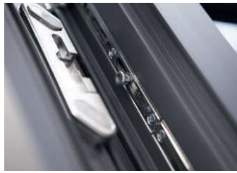
Multi secuir (rozszczelnienie okna)
